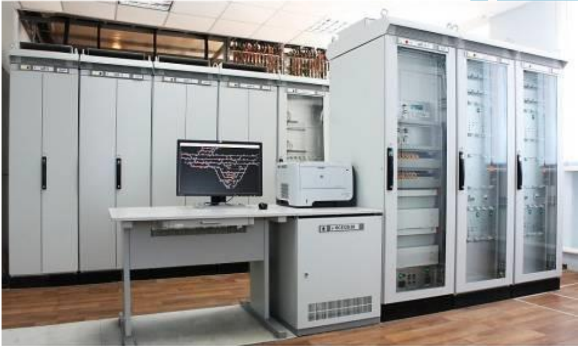
МПЦ-У на станции (релейное помещение)
